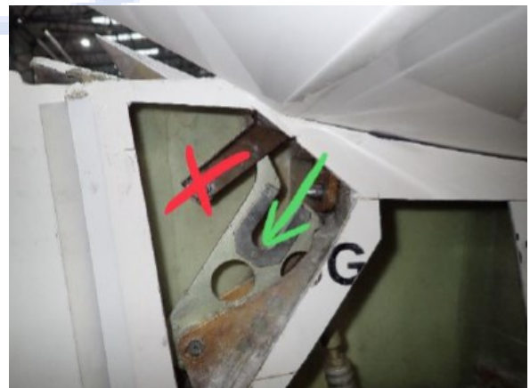
falsch montierte Höhenruderansteuerung (Ruderanschluss nicht in der vorgesehenen Führung)
